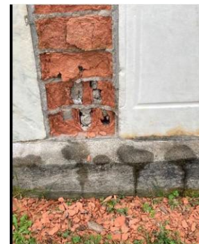
2022 - La Fabrique n'a fait aucun effort pour entretenir le mur. Cela signifie que les joints n'ont jamais été refaits et que l'eau s'est infiltrée à l'arrière des briques.
